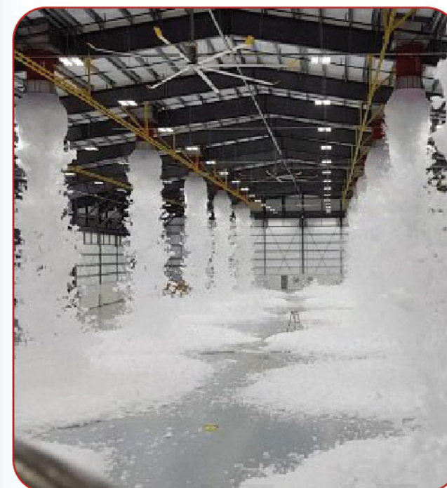
HỆ THỐNG CHỮA CHÁY BẰNG BỘT
